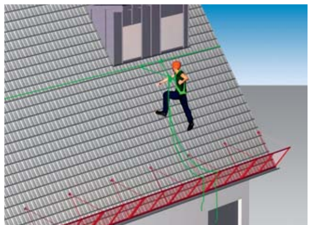
Bild 14 Arbeit am hängenden Seil. Als Zusatzmassnahme wurde eine Dachfangwand montiert, um herunterfallendes Material aufzufangen.
